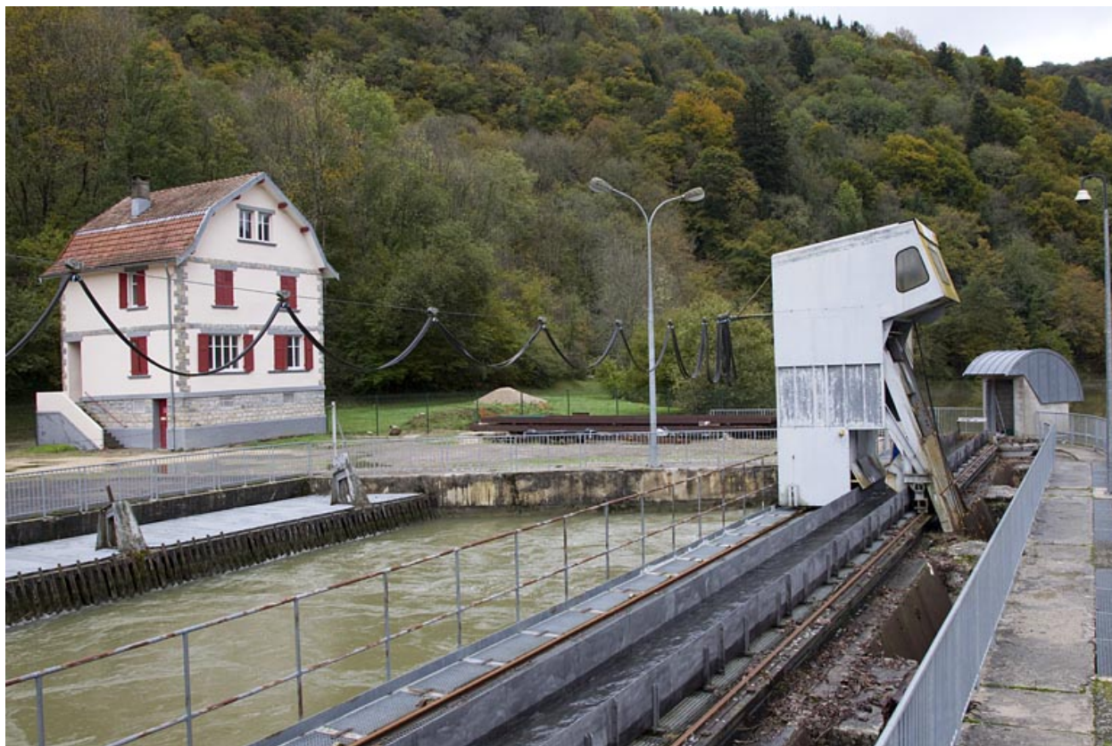
Prise d'eau : vue d'ensemble du dégrilleur.
