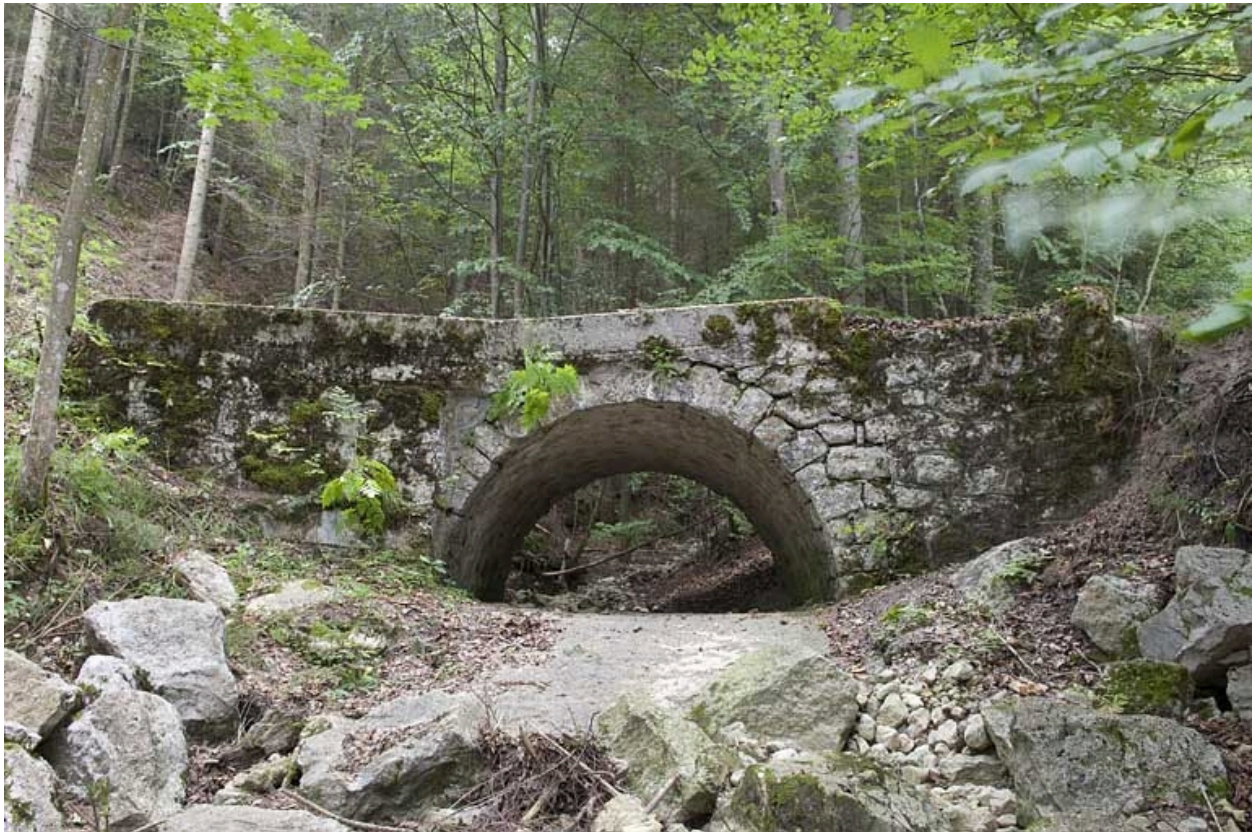
Pont sur le ruisseau de la Grange des Pauvres (n° 7), vu depuis l'aval.
