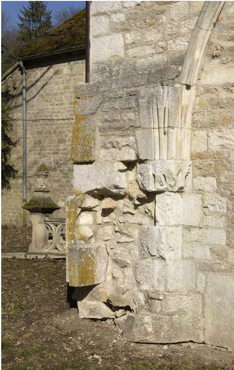
Extrémité nord de l'aile orientale : mur sud, vestiges de la salle capitulaire.
