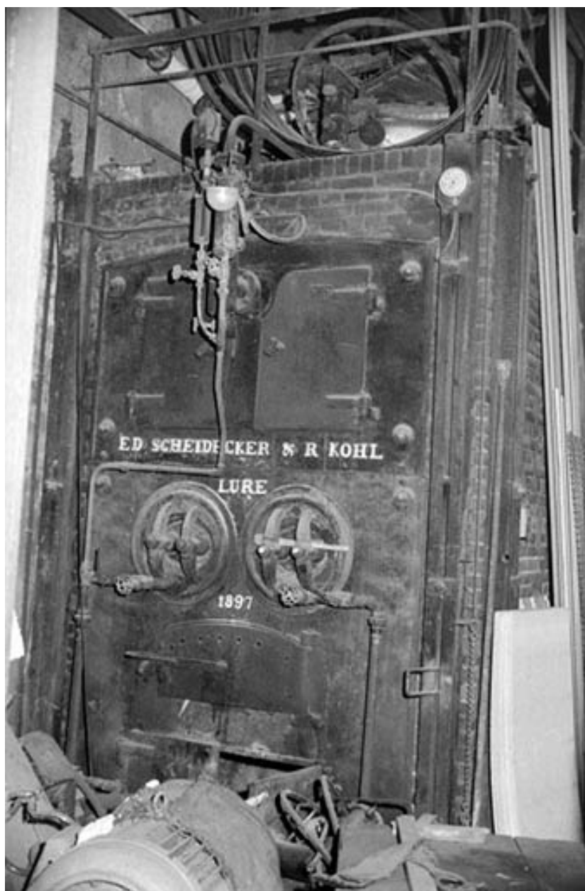
Atelier (C) : chaudière Scheidecker et Kohl.
