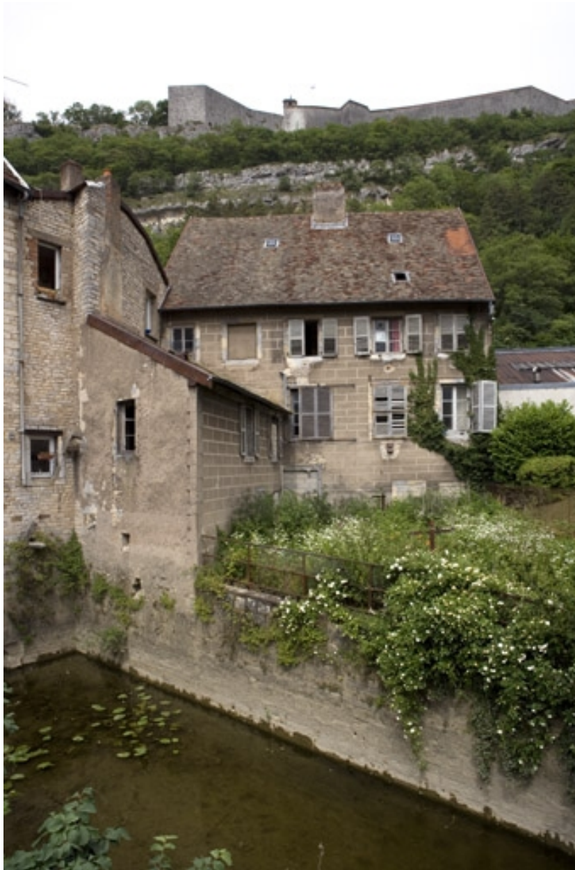
Façade postérieure des logements désaffectés.
