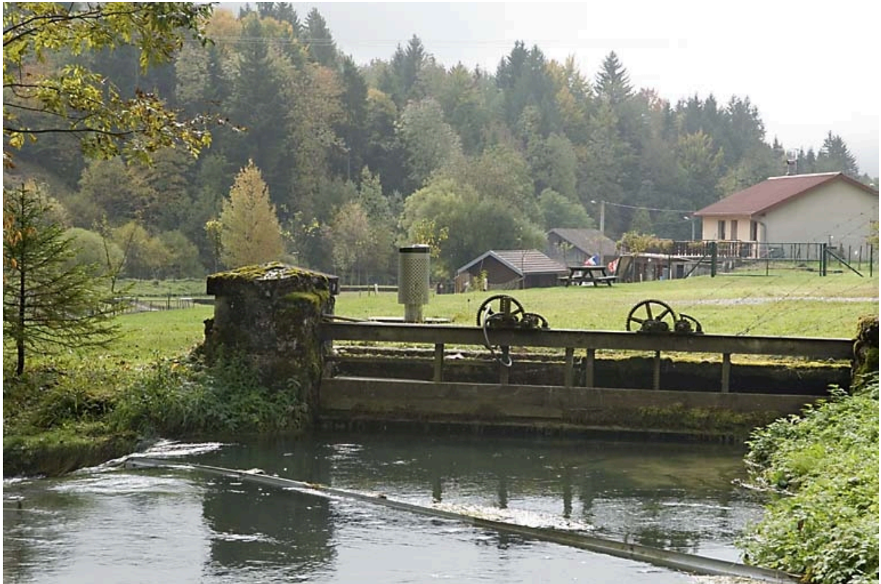
Vannage de prise d'eau.
