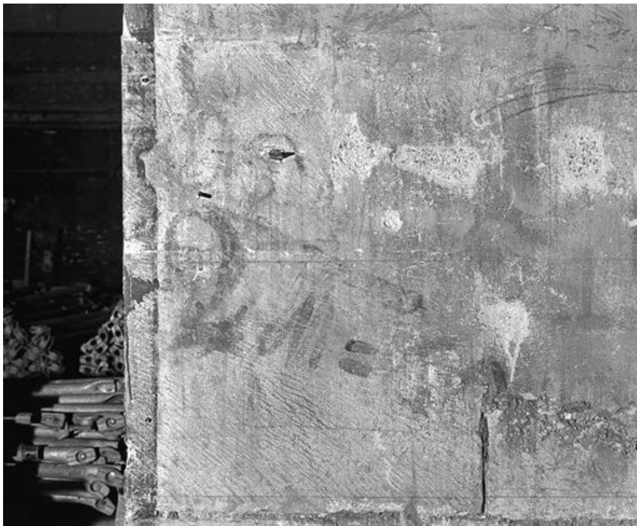
Choeur, mur nord : graffiti.
