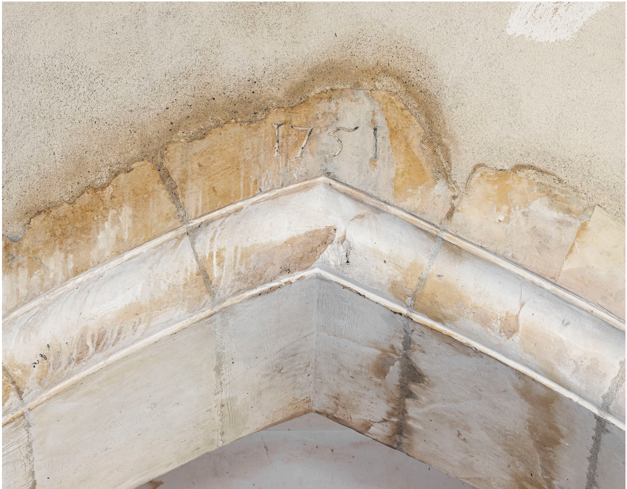
Arc brisé du transept nord : date (1751).
