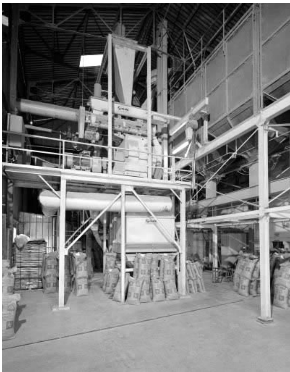
Atelier de fabrication. Broyeur Stolz.
