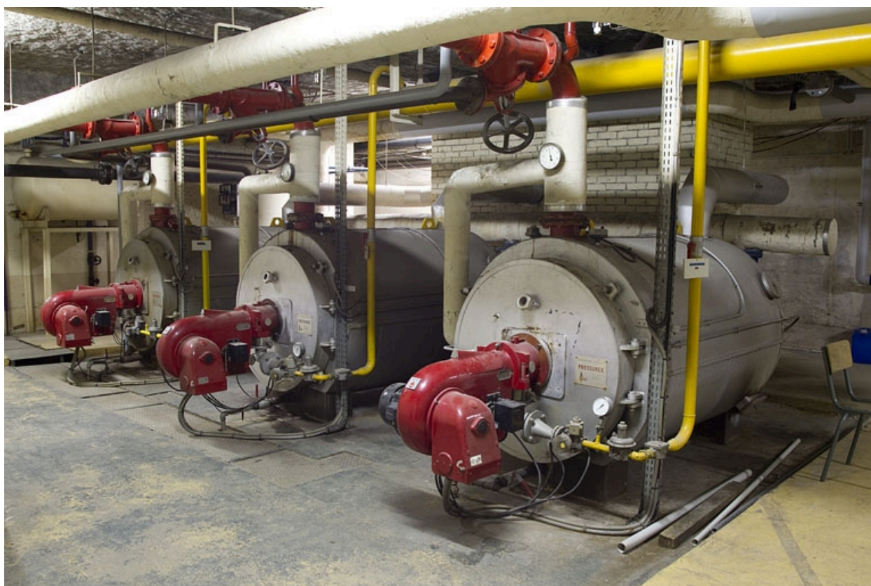
Externat (sous-sol), chaufferie : les chaudières.
