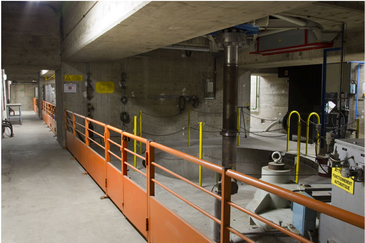
Etage inférieur de la salle des machines.
