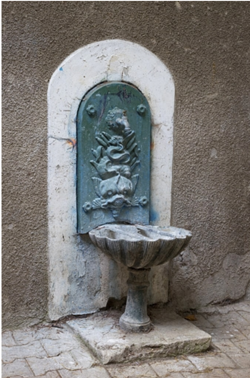
Vue d'ensemble de la borne fontaine située dans la cour.
