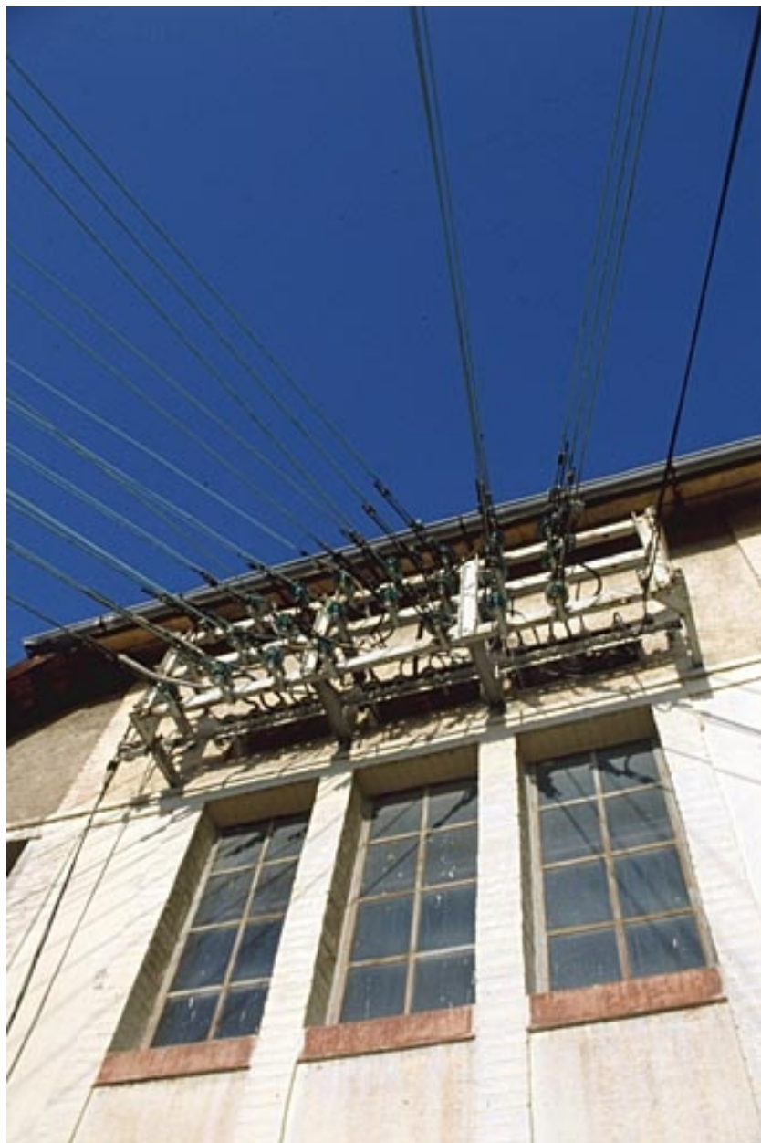
Détail du transformateur : départ de fils électriques.
