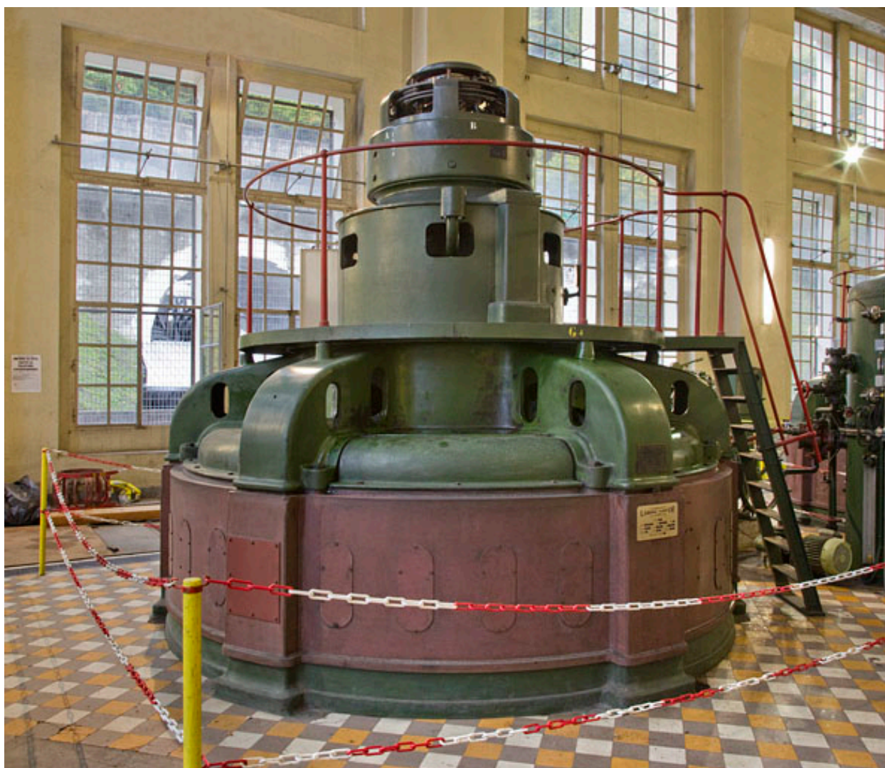
Centrale de Liebvillers : alternateur du groupe n° 4.
