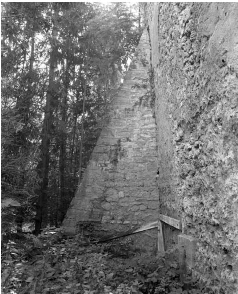
Restes de rempart du bastion de la Visitation (derrière la rue Cécile) : détail d'un contrefort.
