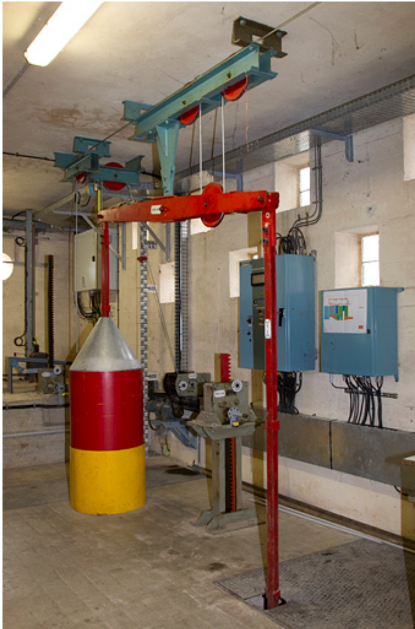
Barrage : soupape d'une vanne toit.
