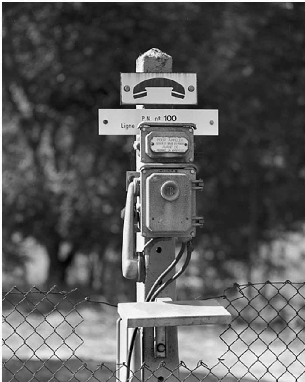
Téléphone de voie du passage à niveau n° 100.
