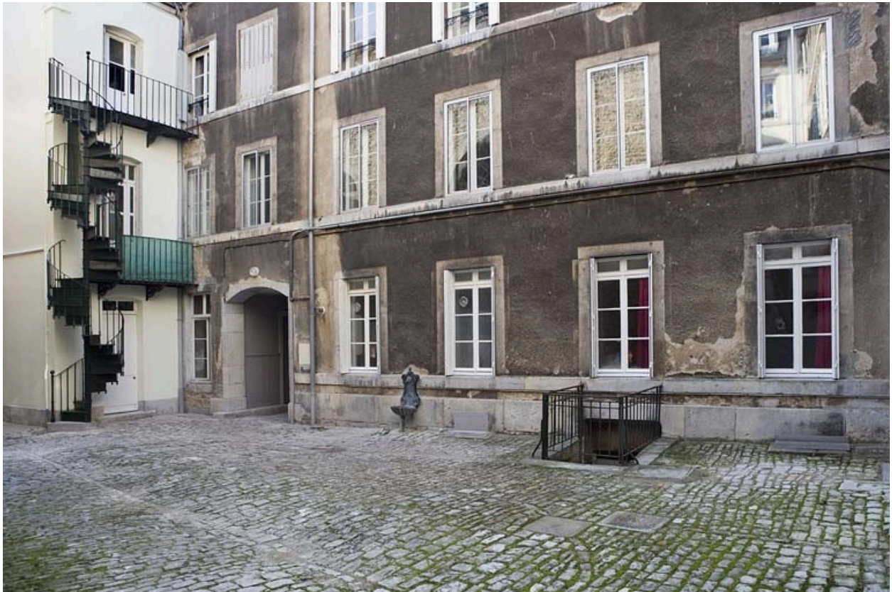
Deuxième cour : vue de la façade postérieure du logis secondaire, de trois quarts droit.
