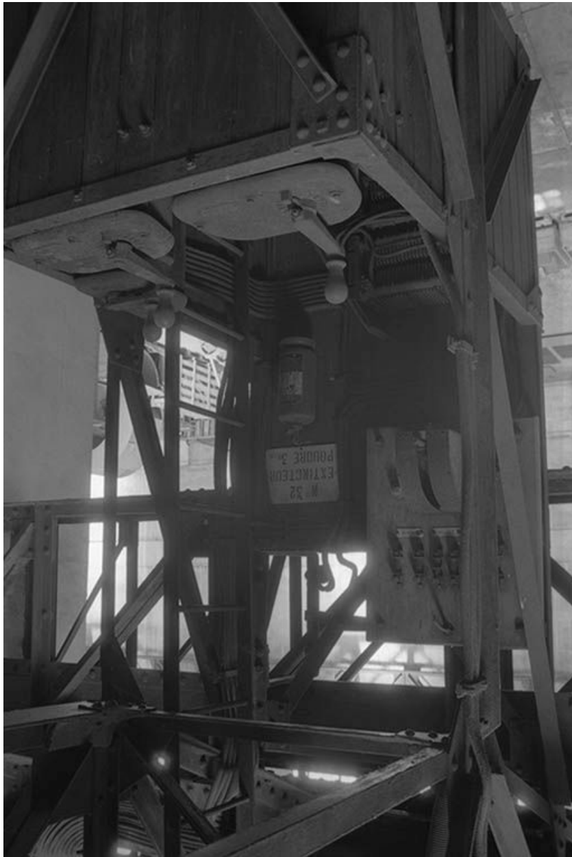
Le poste de commande du pont roulant de la salle des pompes.
