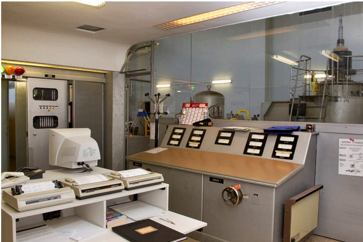
Poste de commande.
