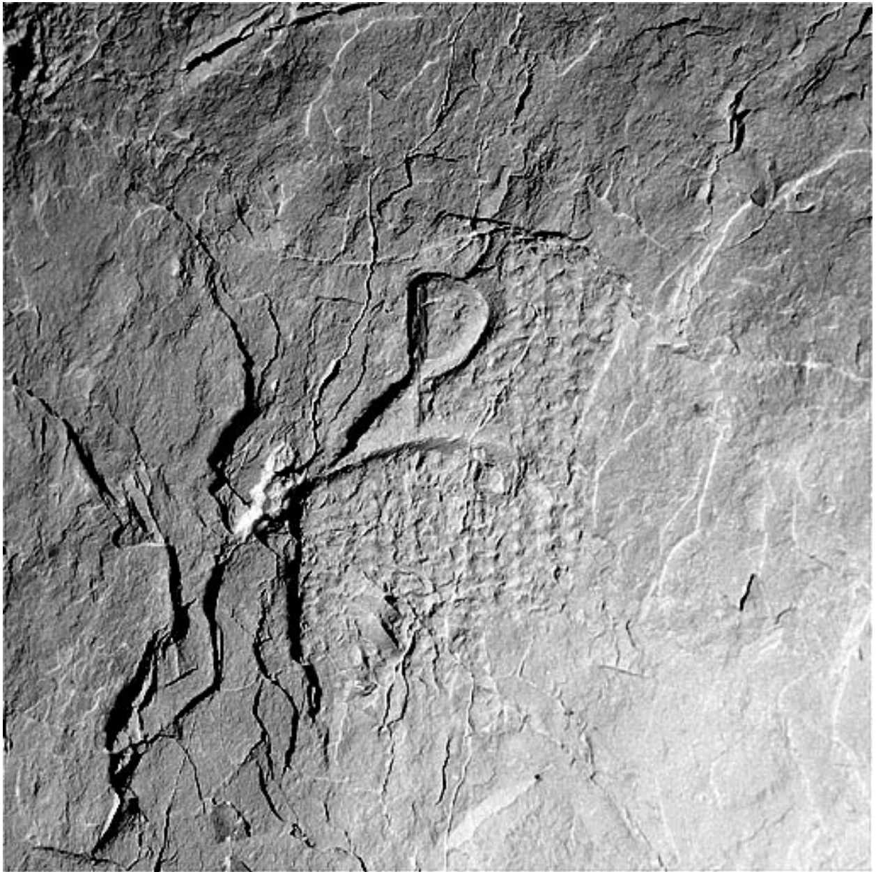
Traces de boucharde et signe lapidaire sur le parement calciné de la pile VIIS.
