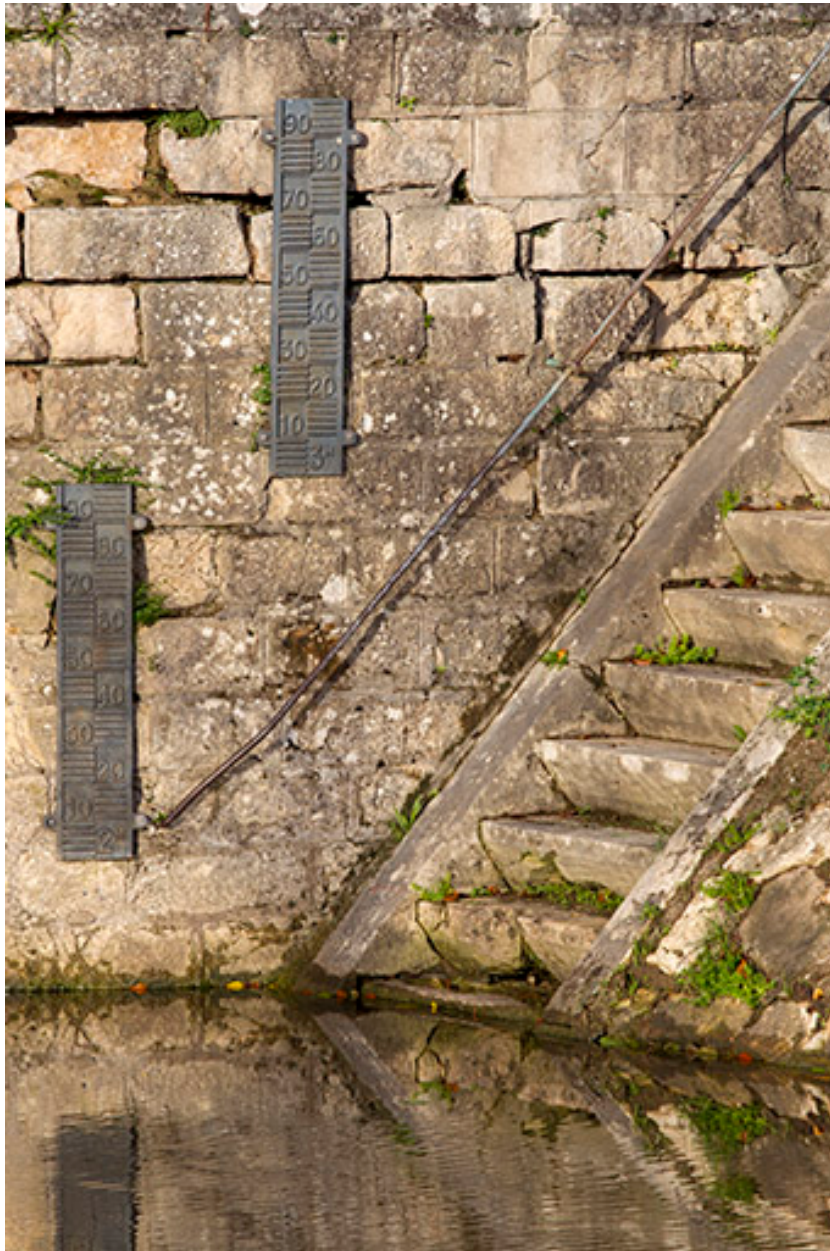
Echelles limnimétriques , porte de garde.
