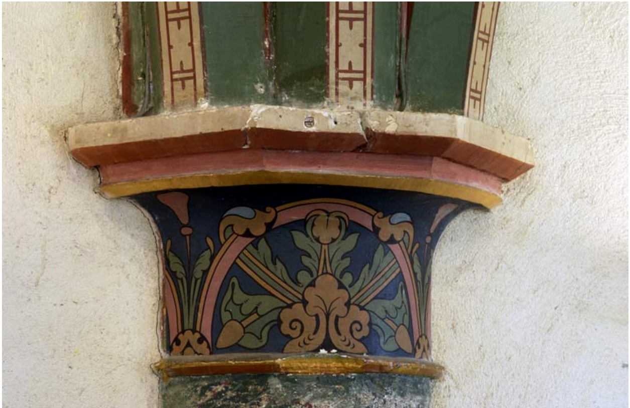
Partie sud de l'aile orientale : salle Garnier II de Sombernon, chapiteau à décor peint.
