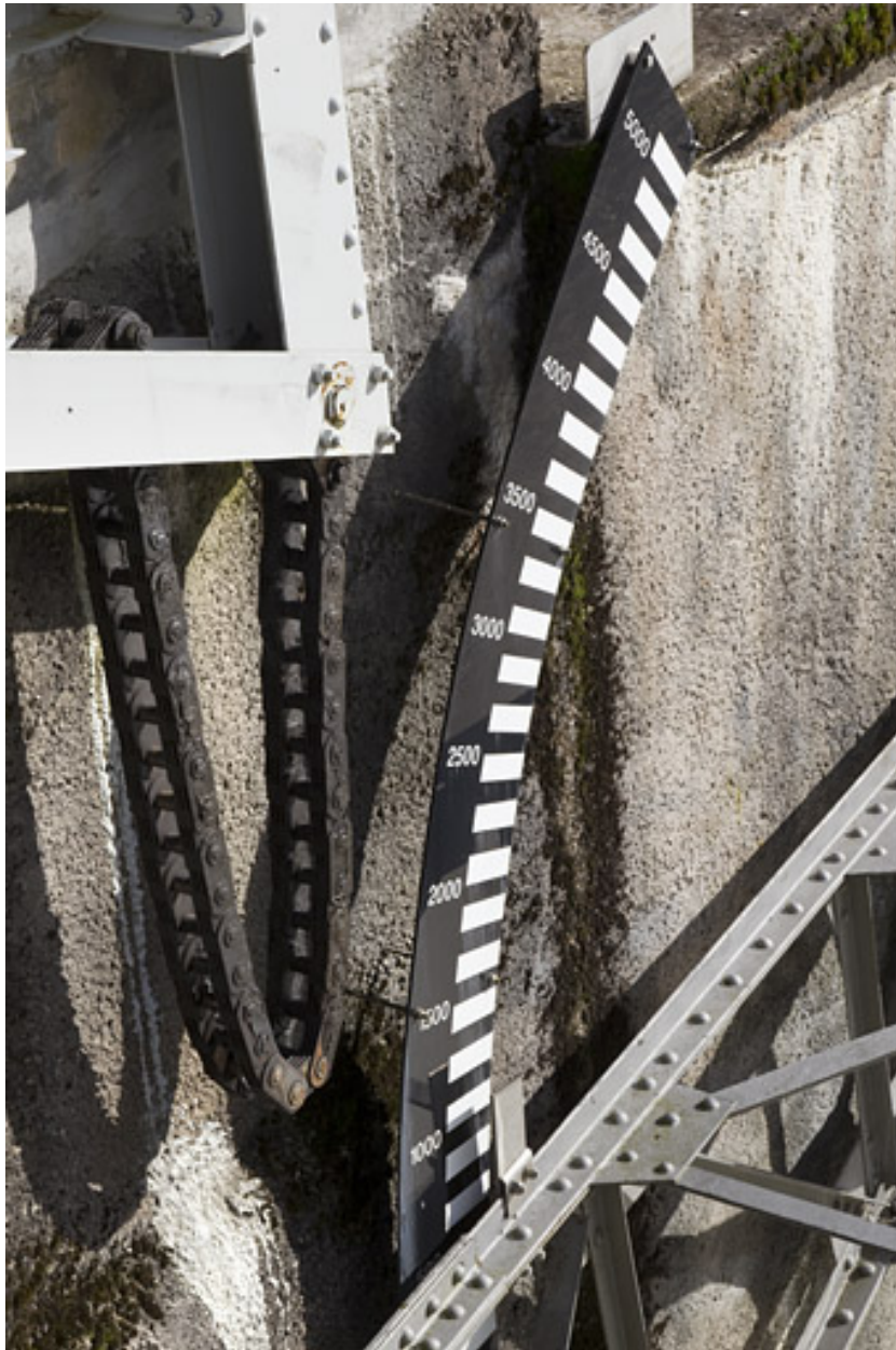
Barrage : repère mesurant l'ouverture d'une vanne secteur.
