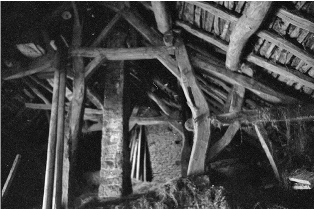
Ferme cadastrée 1960 B 107, située au lieudit La Peyrouse : détail de la charpente d'un toit en laves.
