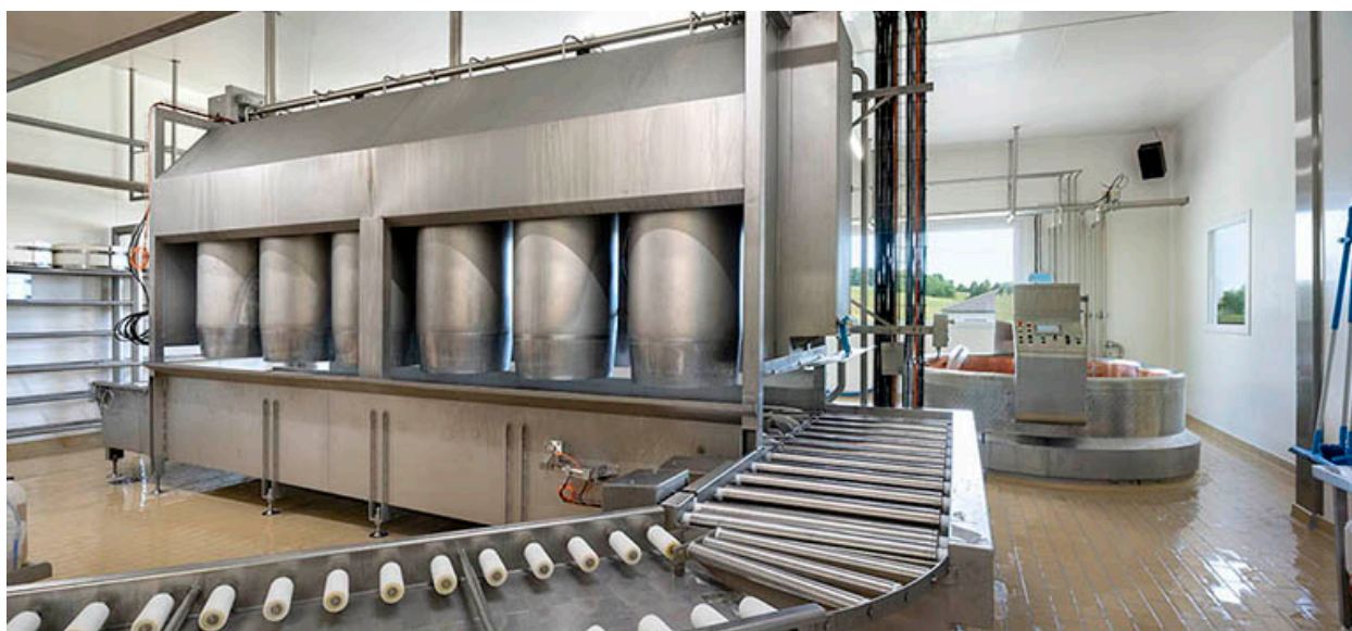
Atelier de fabrication : système de moulage.
