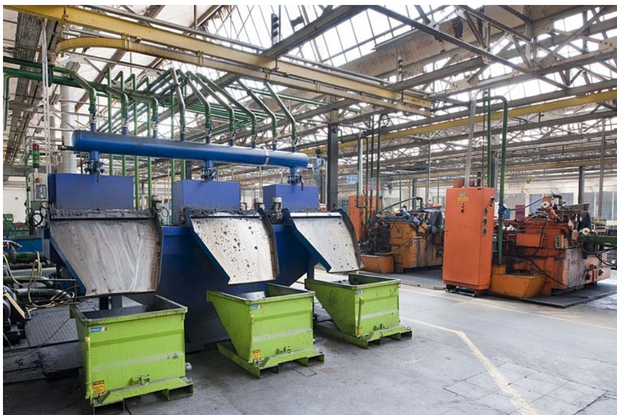
Atelier d'usinage nord.
