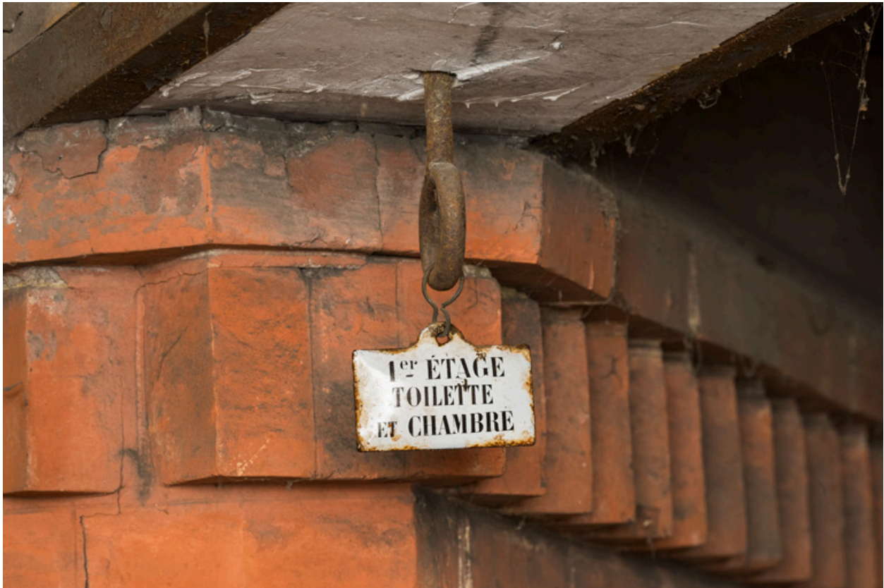
Calorifère au sous-sol, détail : étiquette suspendue à un conduit ("1er étage toilette et chambre").
