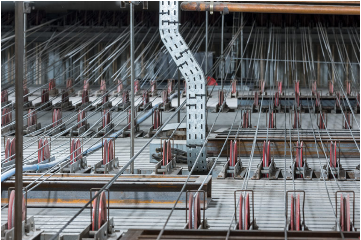
Maison de la culture, grande salle : le gril, vue rapprochée.
