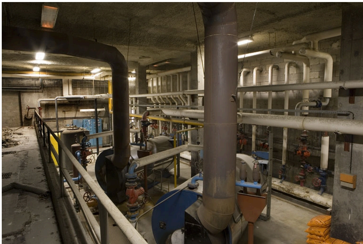
Bâtiment D. Sous-sol. Vue de la chaufferie.
