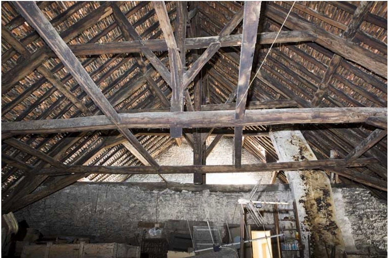
Intérieur, comble : vue de la charpente depuis le fond du grenier, vue rapprochée.
