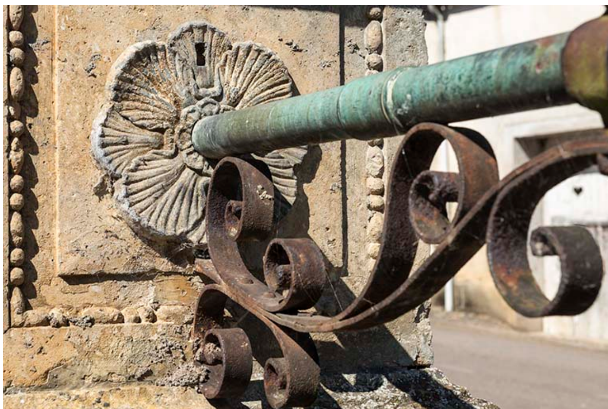
Détail du jet en fonte.
