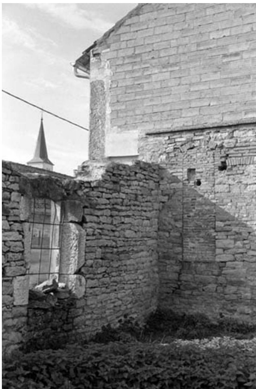
Baie murée, vestige d'un four.
