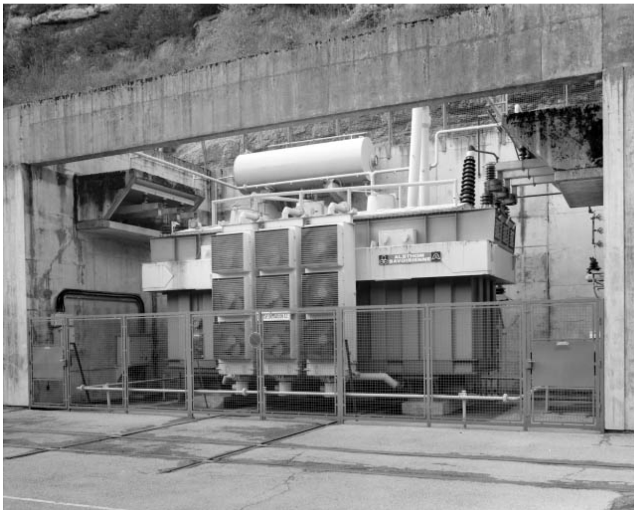
Transformateur Alsthom de 160 MVA.
