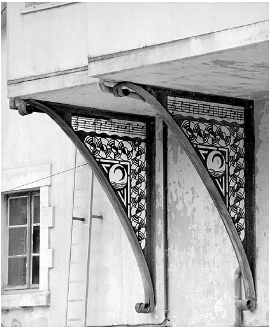
Consoles de la cabine de projectionniste.
