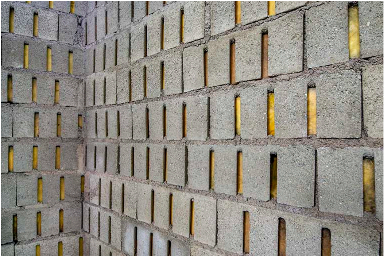
Grand Kursaal : mur anti-bruit du local de la ventilation.
