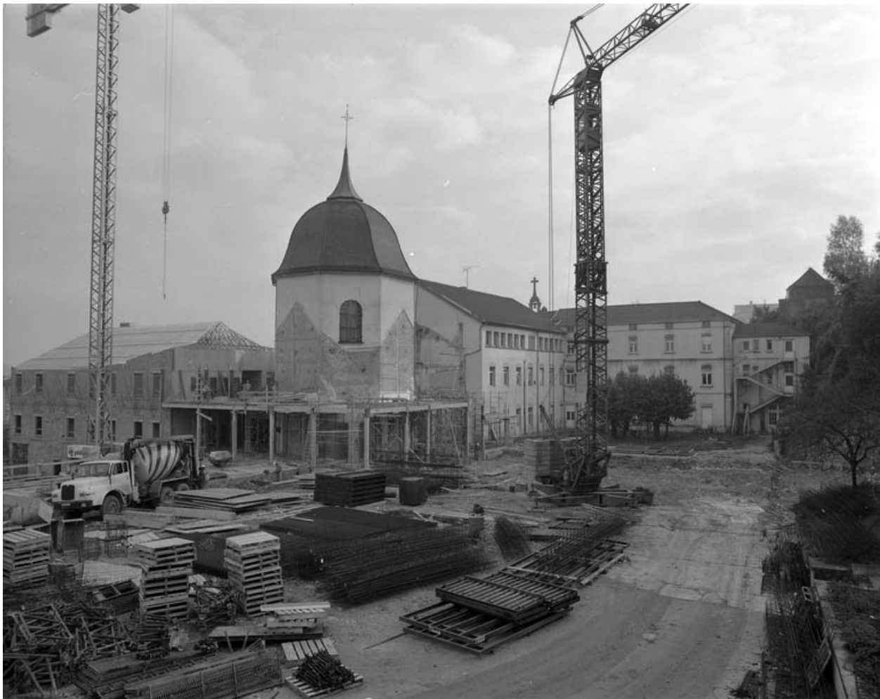
Chapelle depuis la cour donnant rue de l'Arsenal pendant les travaux de démolition de l'année 1989.
