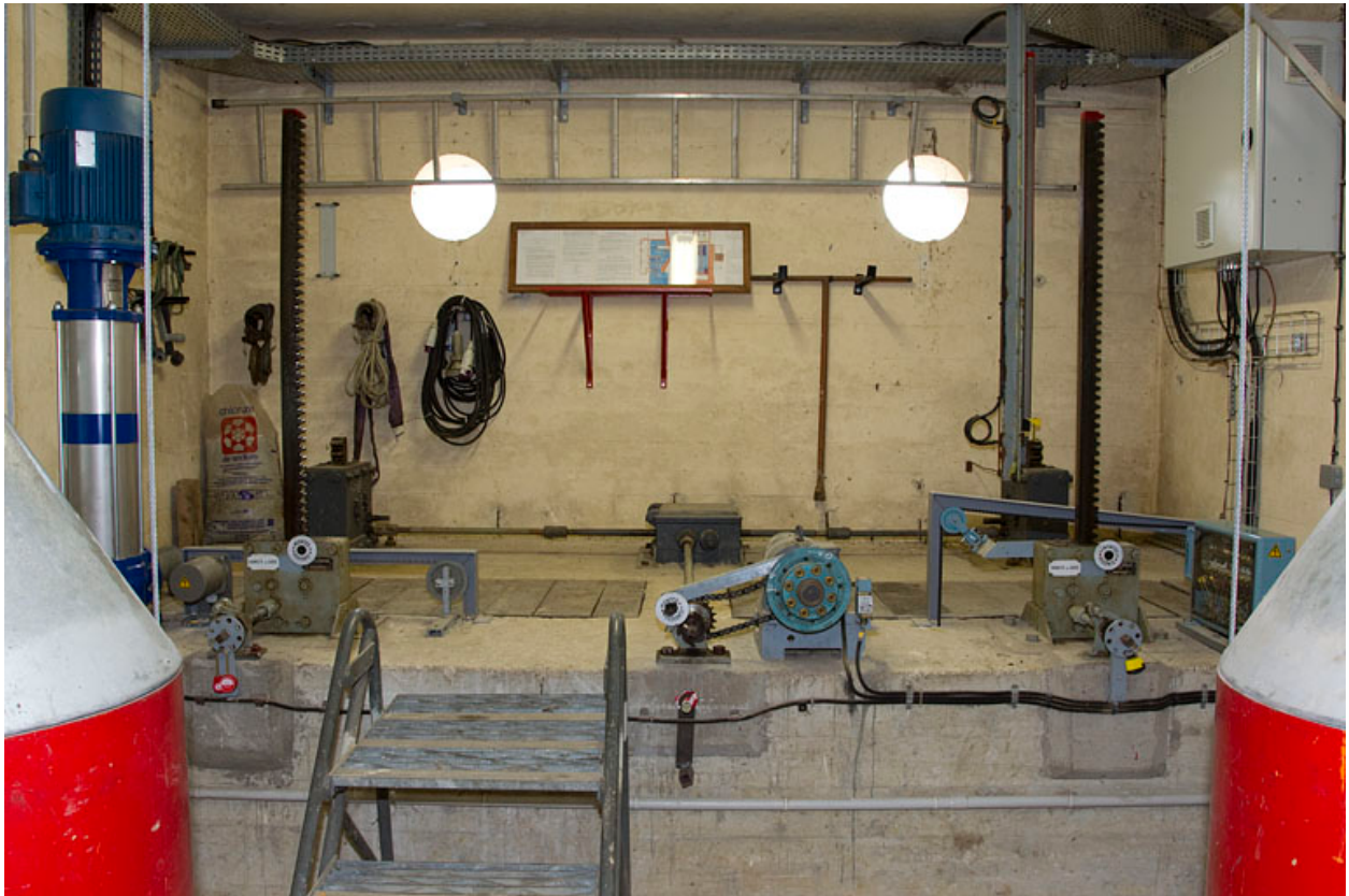
Barrage : commande des vannes de garde.
