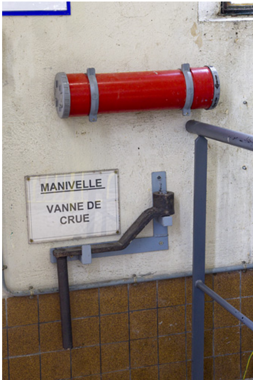
Manivelle de secours (commande du vannage).
