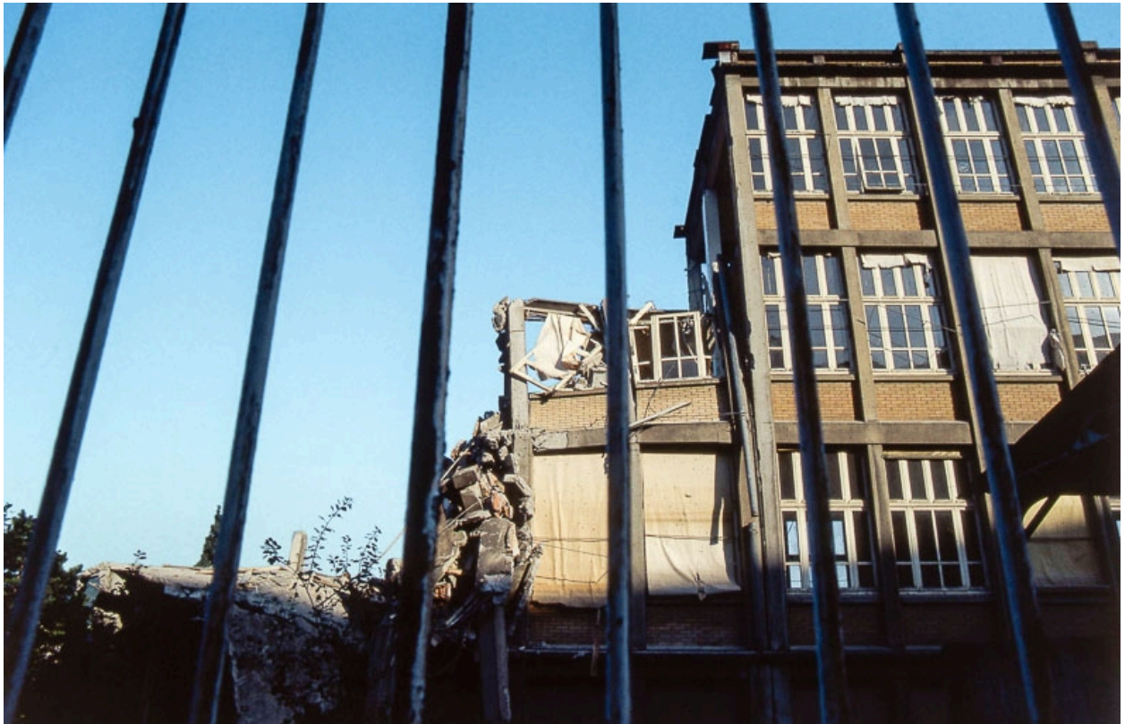
Destruction de l'usine : façade sur l'avenue Villarceau vue au travers de grilles.
