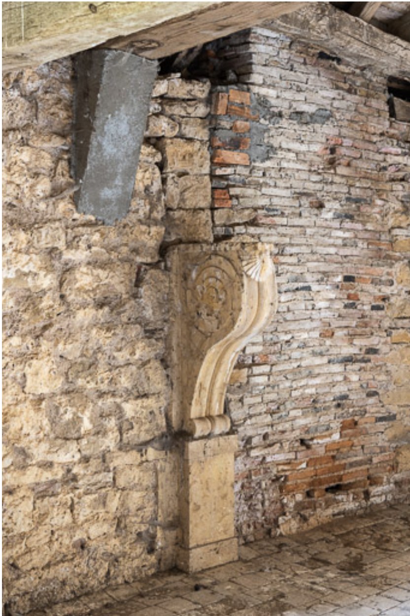
Vestige de la cheminée du second étage de la tour : console à décor de volute et coquille supportant à l'origine le manteau de la cheminée
