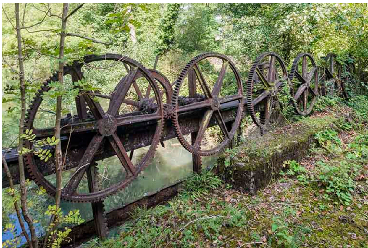
Mécanisme de levage du vannage.
