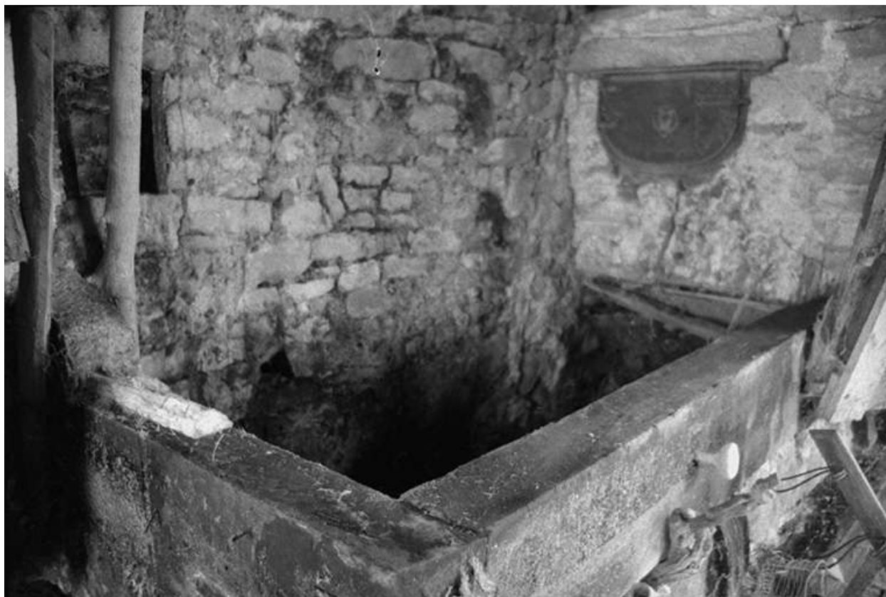
Ferme cadastrée 1960 B 108, située au lieudit La Peyrouse : cheminée et four à pain.
