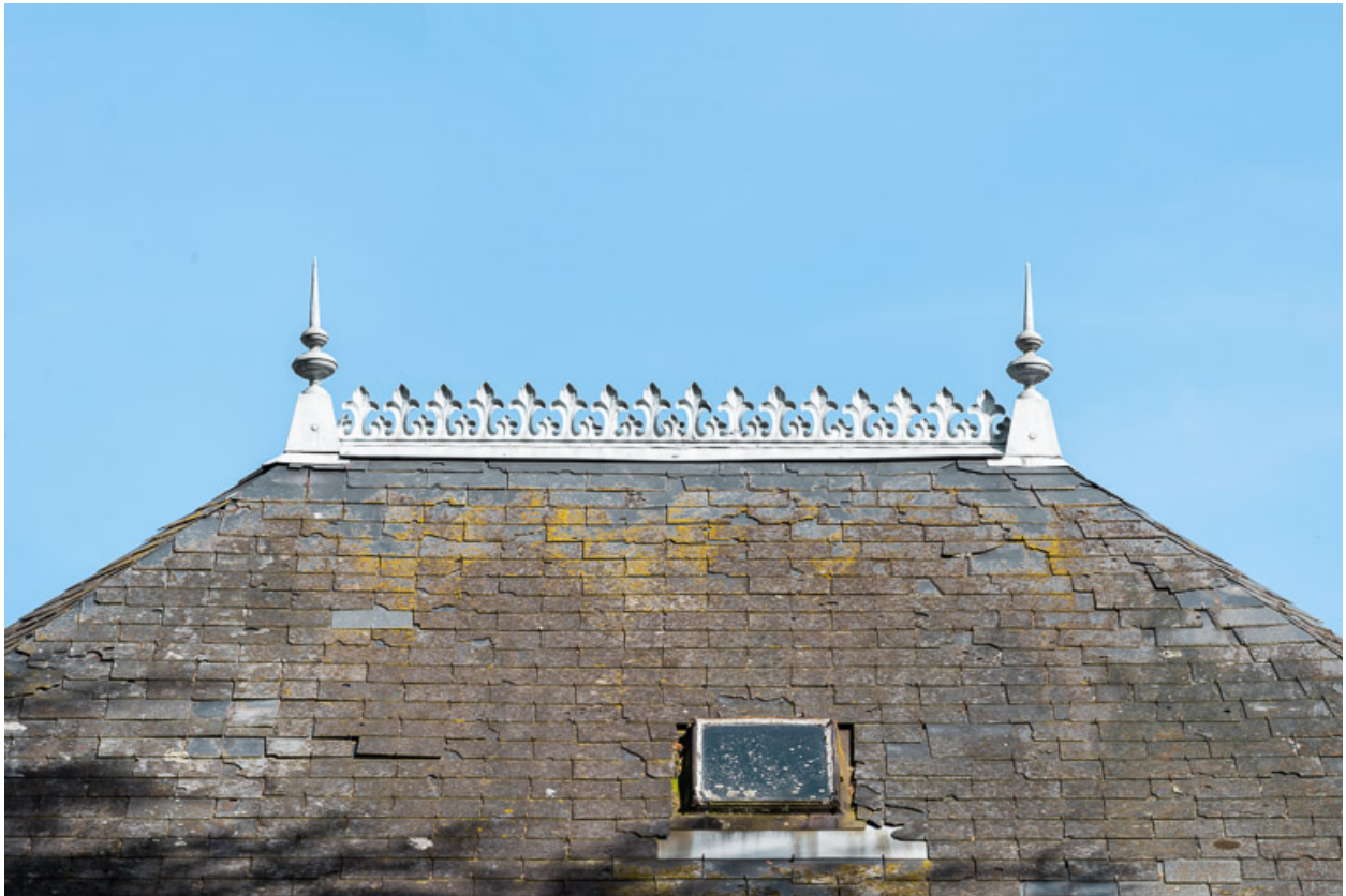
Crête de la toiture de la tour de plan rectangulaire, vue depuis l'ouest.
