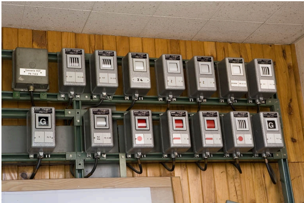
Galleries de répéteurs optiques et sonnerie.
