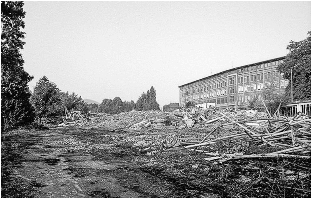
Destruction de l'usine, 25 août 1993 à midi : vue d'ensemble depuis le nord-est.
