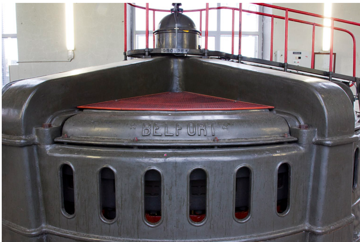
Détail d'un alternateur SACM.
