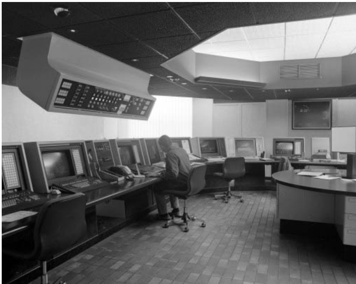
Intérieur de la salle de contrôle de la Salle 5 : écrans de contrôle.
