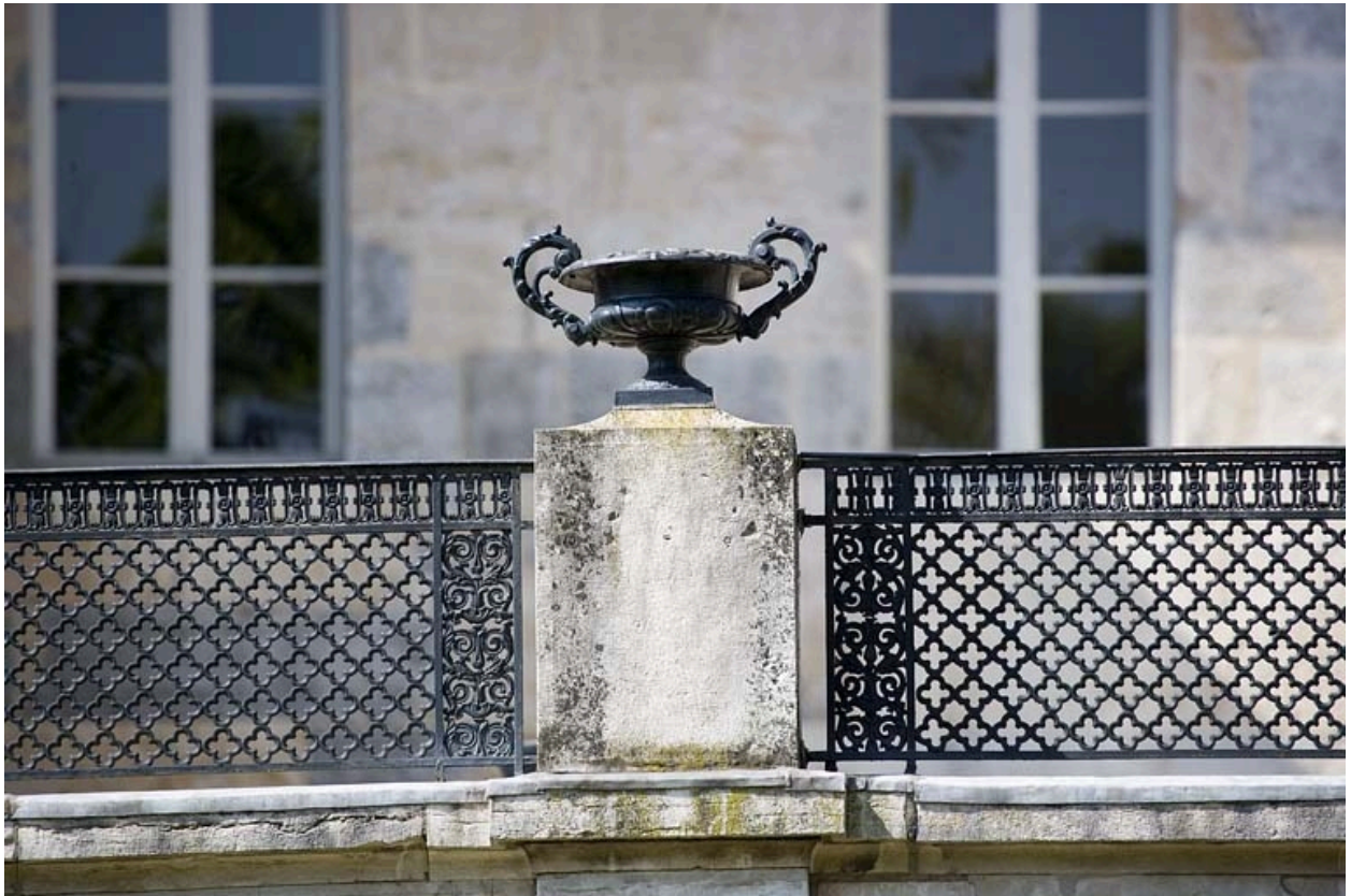
Détail d'un vase en fonte ornant le parapet de la terrasse du jardin d'hiver.
