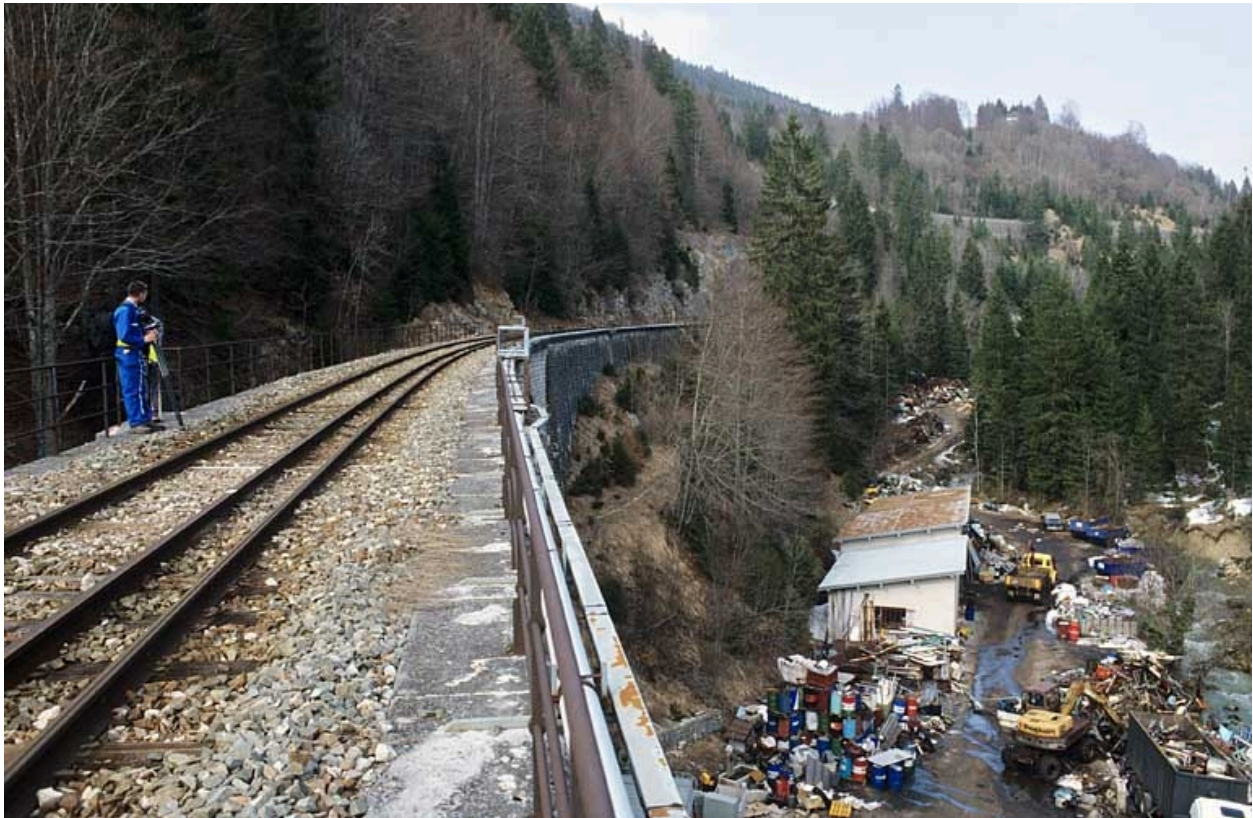
Extrémité côté Andelot-en-Montagne, vue depuis la voie au sud (côté La Cluse).
